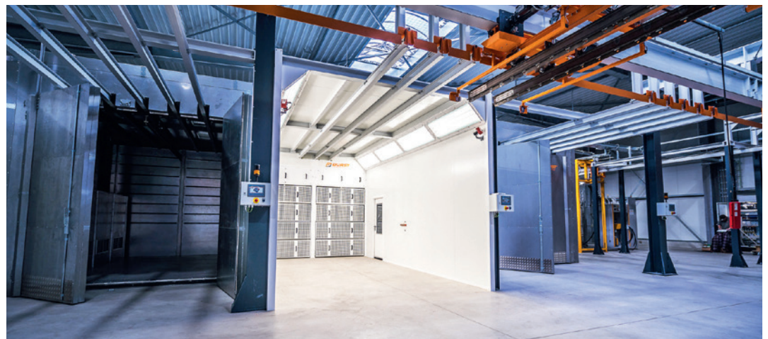
Um die bis zu 500 kg schweren Baugruppen durch die Beschichtungstechnik zu fahren, sind für die jeweiligen Prozessschritte Förderstrecken erstellt. Foto: Durst
